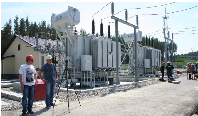
Рис. 1. Процесс сканирования оборудования на подстанции
