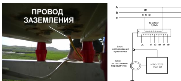
Рис. 2. Заземление трансформатора напряжения
