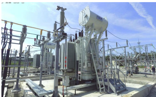
Рис. 4. Исследуемый трансформатор 110/20кВ 40 МВА в скан-снимке
