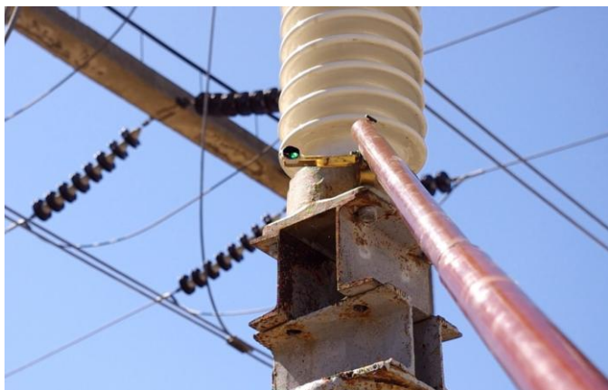
Рис. 6. Индикатор дефекта у опорного изолятора в ОРУ 110 кВ
