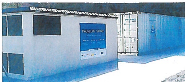
Установка с инерционным накопителем, предоставленная ABB на Ла Гомера.
