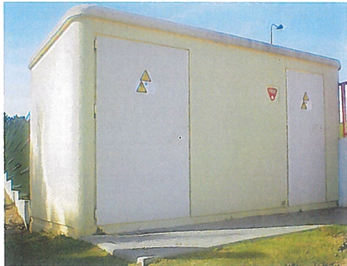
Эта закрытая подстанция, установленная в городском районе, предназначена для размещения распределительных устройств среднего напряжения и трансформаторов напряжением выше 250 кВА и распределительного щита низкого напряжения.
