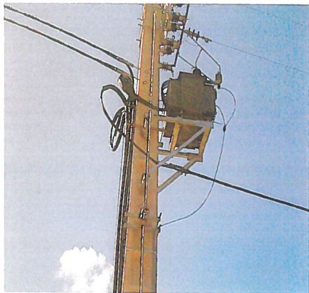
Обычная столбовая подстанция в сельской местности с использованием трансформаторов до 250 кВА.
