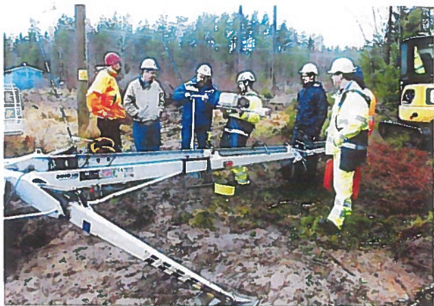
Бригада монтажников из компаний Pöyry Swedpower/Vattenfall/USi производит сборку метеостанции в полевых условиях.
