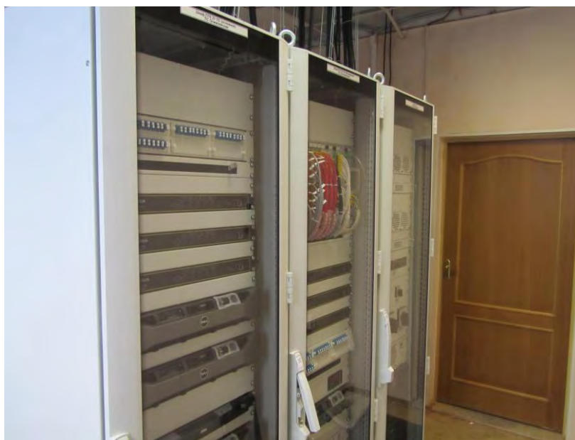
Рис. 3: Пример размещения в ОПУ шкафов с серверами ПТК ЗУ ПС и СГП.
